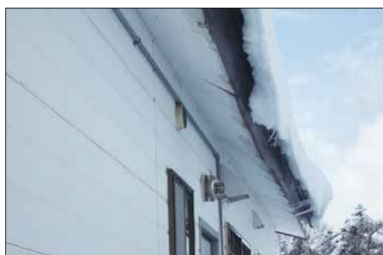
令和4年1月 軒先の破損 (雪の重みで軒先が湾曲)
